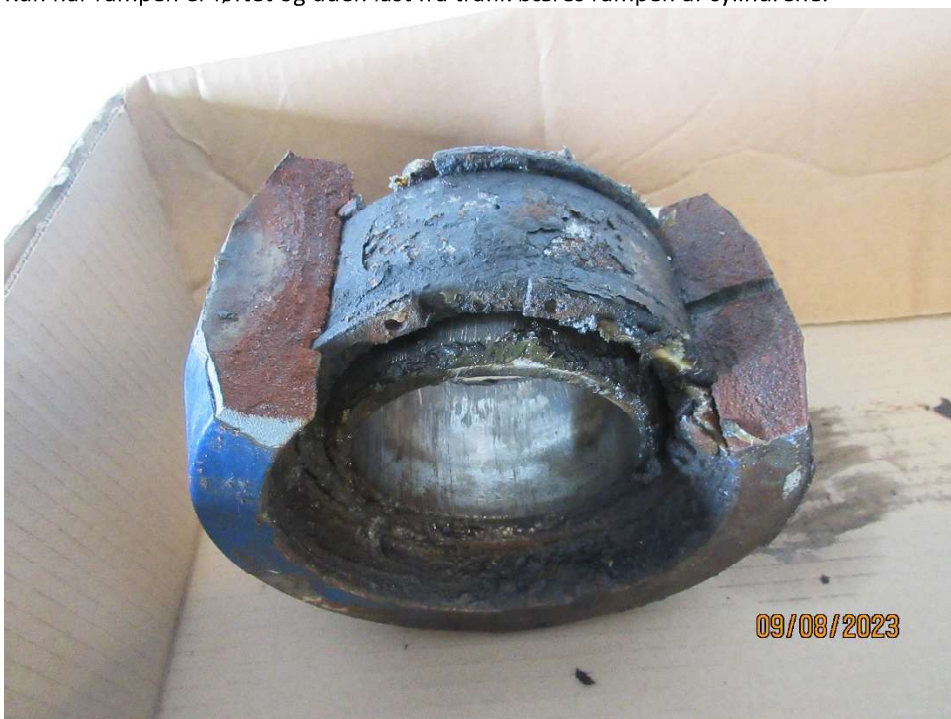
Foto 4: Omtalte ledøje der svigtede. Der er tydelige spor efter at en stor del af det lastbærende areal har manglet. På billedet ses det som det korroderede område. Det bærende område er blevet for lille i forhold til lasten.
