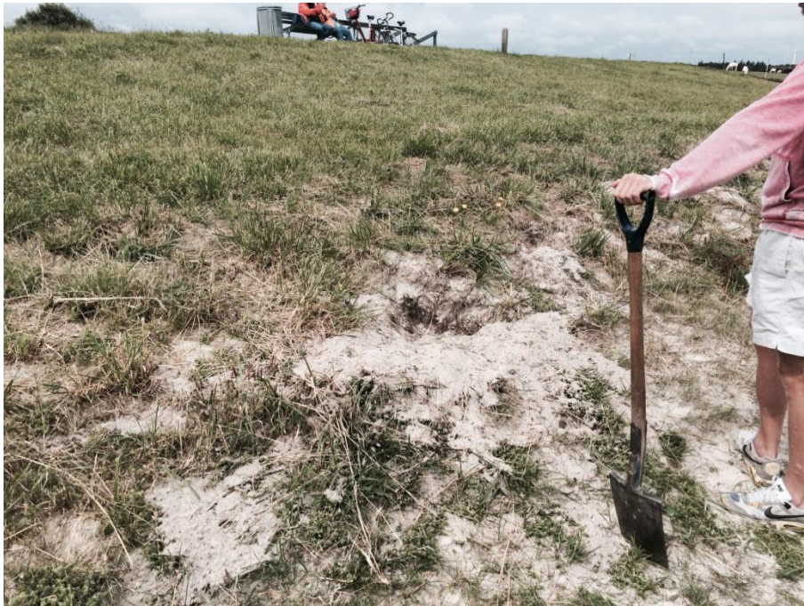
Skader og løst sand på nord-diget ved st. 180-200. (NB! Skaderne er ikke lavet med spaden!)
